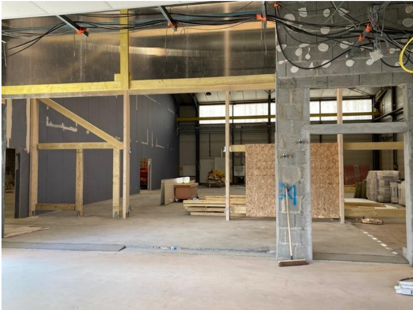
Figure 3 – Travaux en cours dans les futurs locaux des deux ressourceries des Halles en commun
